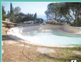
1 Remplissage de la piscine
